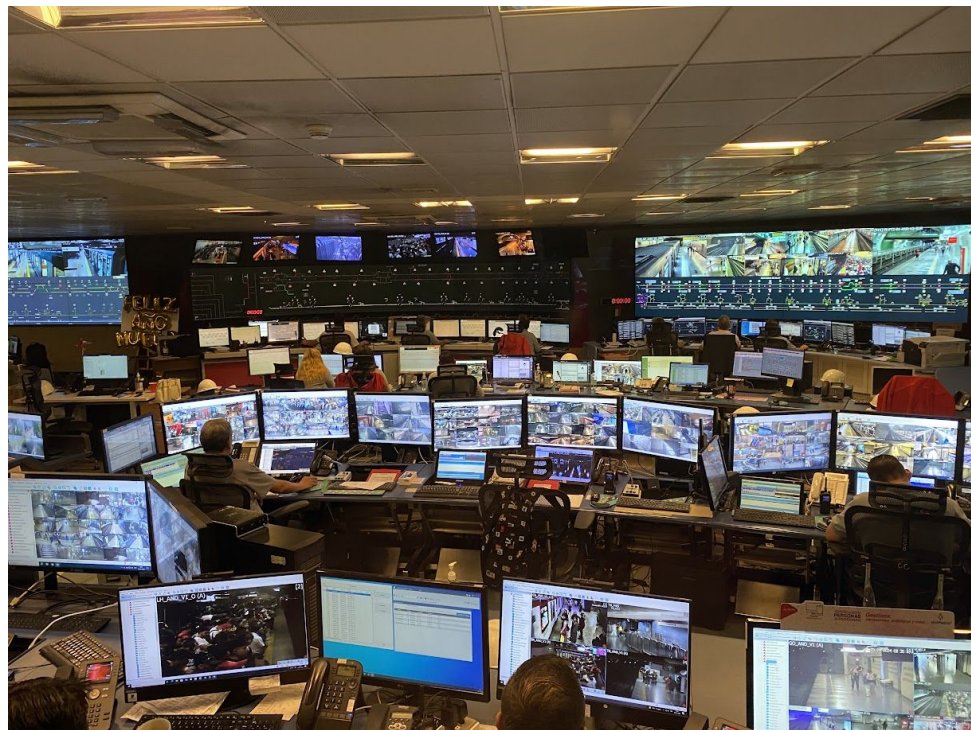
Puesto de comando central (PCC) Líneas Convencionales (L1, L2, L4, L4A, L5)
