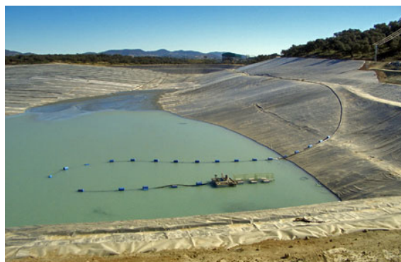
Figura 29. Liners (geotextil) en un depósito de relaves. Fuente: Jon Engels – www.tailings.info
