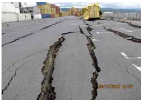
Figura 11. Falla de suelo (GEER, 2010).
