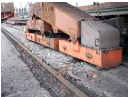
Figura 12. Descarrilamiento de base rodante por falta de topes sísmicos.
