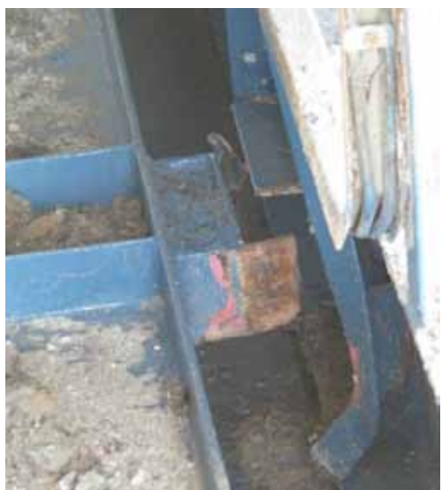
Figura 8. Tope sísmico de caldera destruido.
