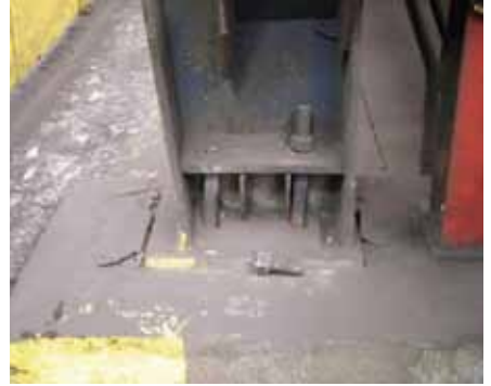
Figura 16. Fluencia y rotura de pernos de anclaje de estructuras.
