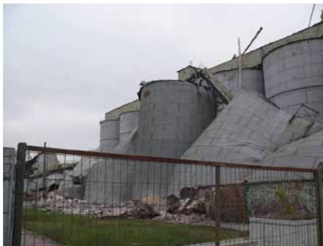
Figura 26. Colapso de silos graneleros en Concepción.
