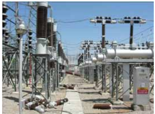
Figura 5. Falla de torre de alta tensión (Araneda et al, 2010).
