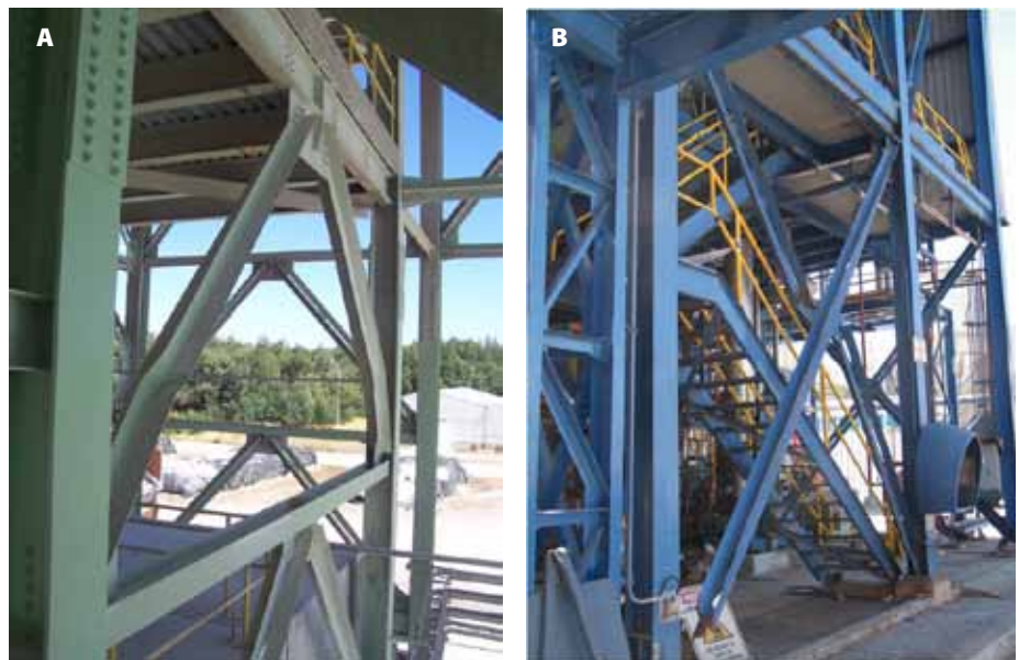
Figura 30. Pandeo global de diagonales. (a) Producto del pandeo local de las alas. (b) Pandeo torsional.
