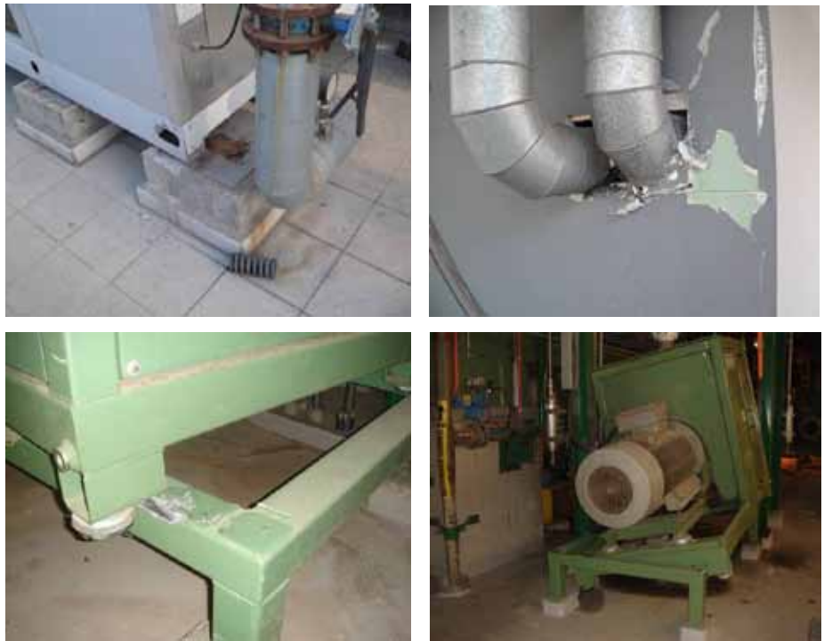
Figura 28. Daños en elementos no estructurales y equipos.
