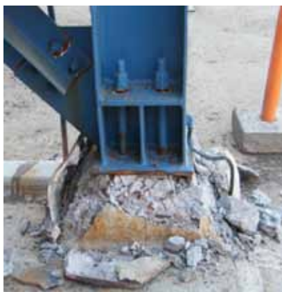
Figura 7. Falla de pedestal.
