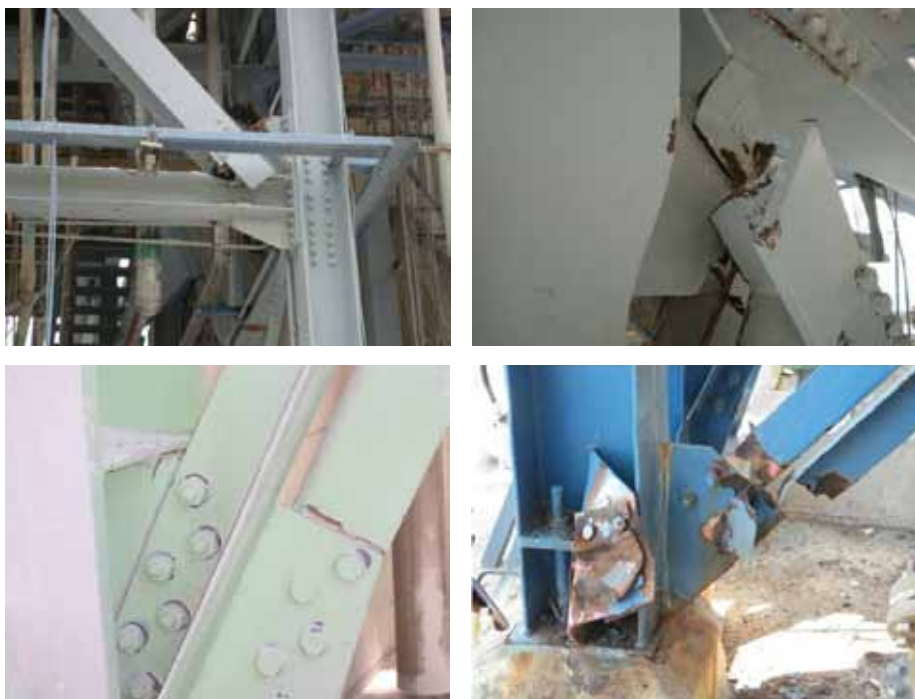
Figura 31. Fallas en conexión diagonal - columna.
