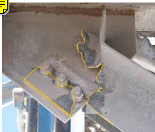
Figura 6. Falla de conexión por arrancamiento del bloque de corte.
