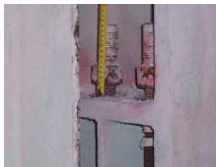
Figura 35. Detalle de pernos de anclaje de columna que fluyeron.
