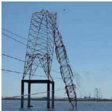
Figura 4. Daños en equipos de transmisión (Araneda et al, 2010)
