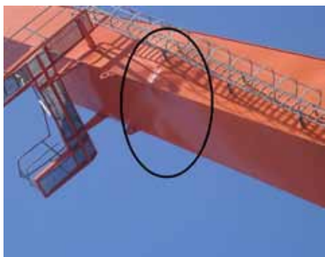
Figura 13. Daño local en grúa por tirón de barco.
