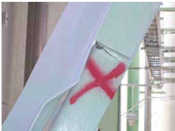
Figura 29. Pandeo local del ala de diagonal XL y Fractura en conexión ala del ángulo con planchuela separadora.
