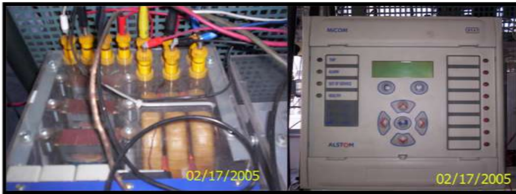
Figura C.15: Vistas relé de protección MICOM - P-141. (a) A la derecha se muestra el panel frontal del relé. (b) A la izquierda se muestra una visión superior del relé, donde se pueden visualizar los transformadores de medida, etc. del mismo.
