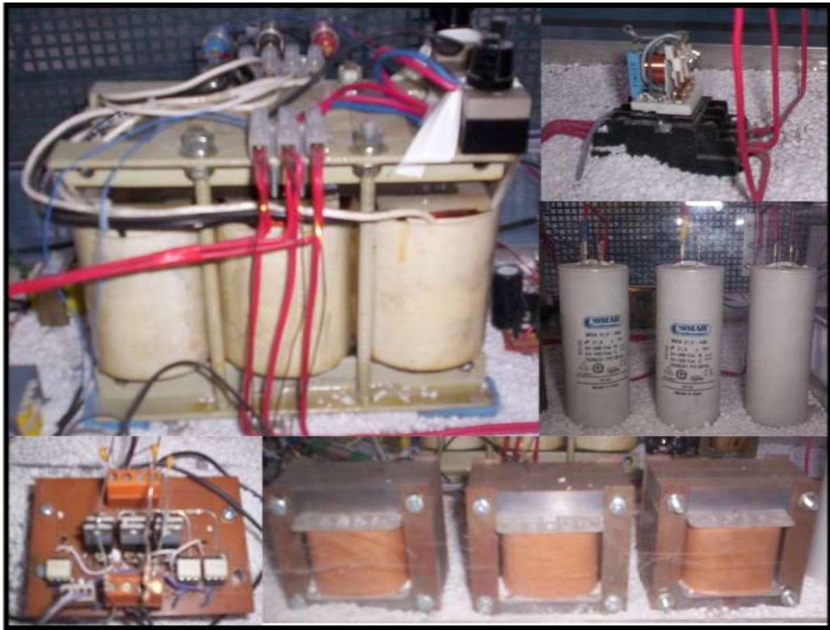
Figura C.10: Elementos analógicos de potencia del sistema. (a) En la parte superior izquierda se muestra el transformador de bajada del SVC. (b) En la parte inferior izquierda se muestra el arreglo de tiristores que dispara la corriente en los reactores. (c) En la parte superior derecha se muestra uno de los relés (interruptores) de conexión de los bancos de condensadores. (d) En la parte al centro a la derecha se muestra uno de los bancos de condensadores del SVC. (e) En la parte inferior derecha se muestran los reactores del SVC
