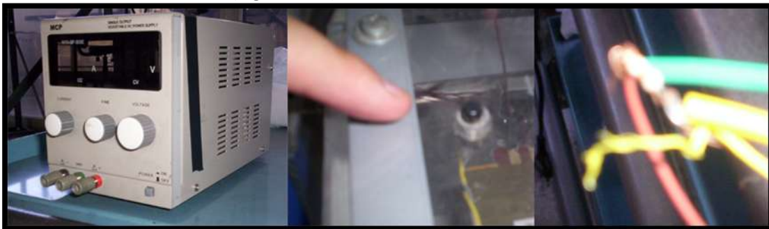
Figura D.1: Encendido relé de protección MICOM P-141. (a) A la izquierda se muestra la fuente de continua que sirve para energizar el relé. (b) Al centro se muestra el pequeño botón que sirve para resetear la medición del relé. (c) A la derecha se muestra la pequeña resistencia que sirve para hacer saltar el sistema.
