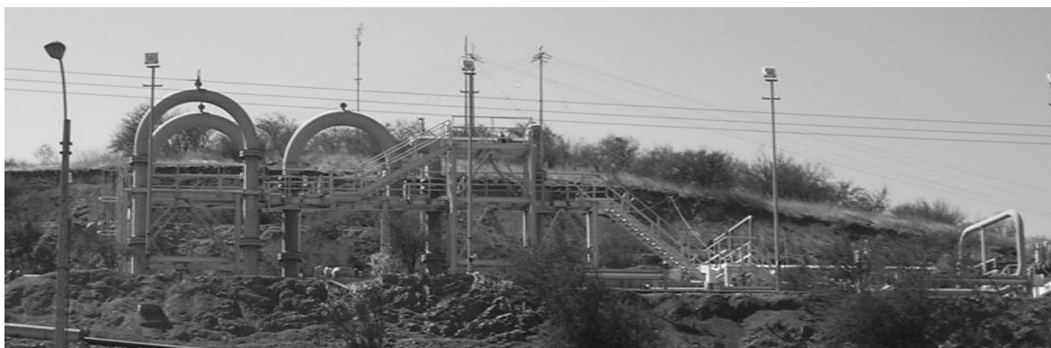
Figura 5.1 Estación disipadora de la planta Las Tórtolas.
