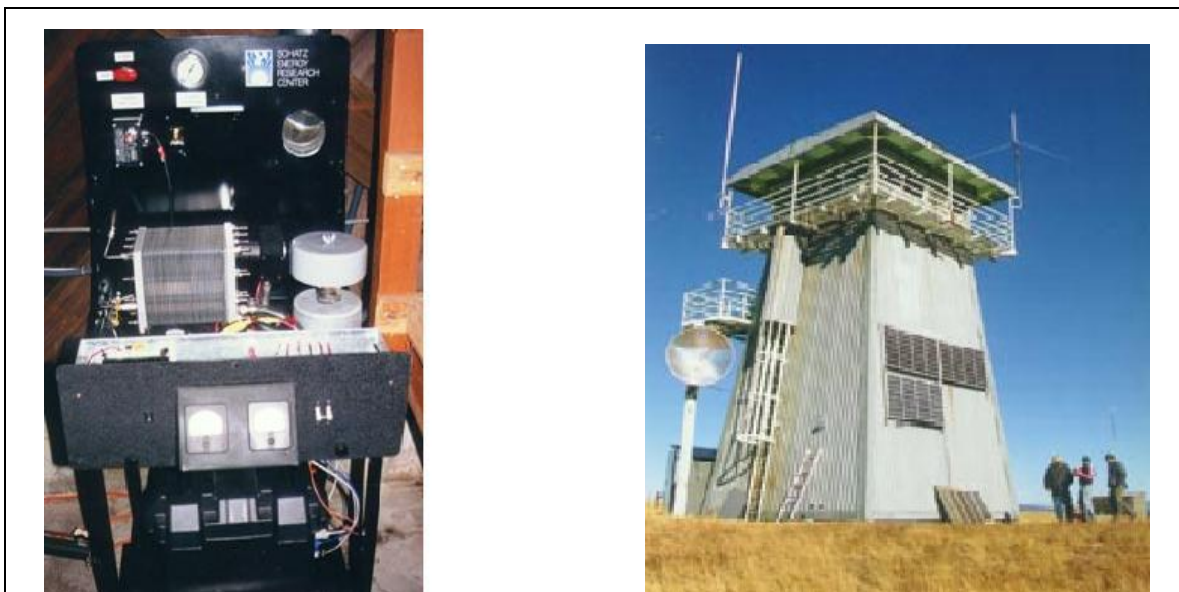
Figura 5.14: Izquierda, dispositivo de control de la CC. Derecha, torre de transmisión de señales.
