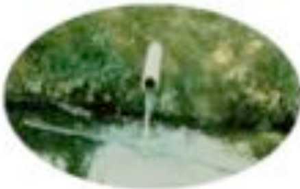
7. No Descargas de colectores
