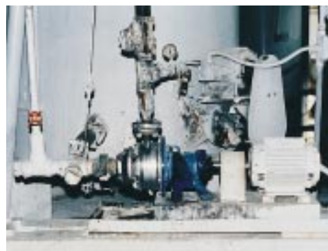
Boiler feed, Alimentación de caldera
