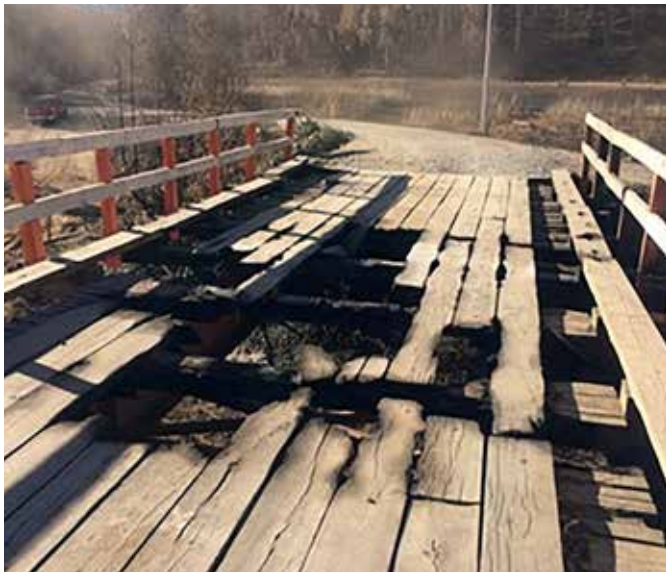
Puente Maggi. Ruta N-414. Provincia de Ñuble, comuna de Quirihue. Pérdida total del tablero superficial y afectación parcial de base.
