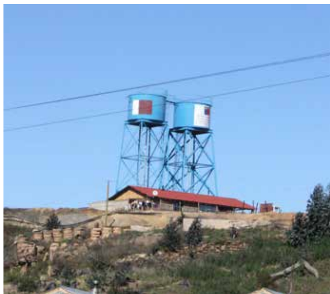
Estanques del Nuevo Sistema de Agua Potable Santa Olga, con bandera de Qatar
