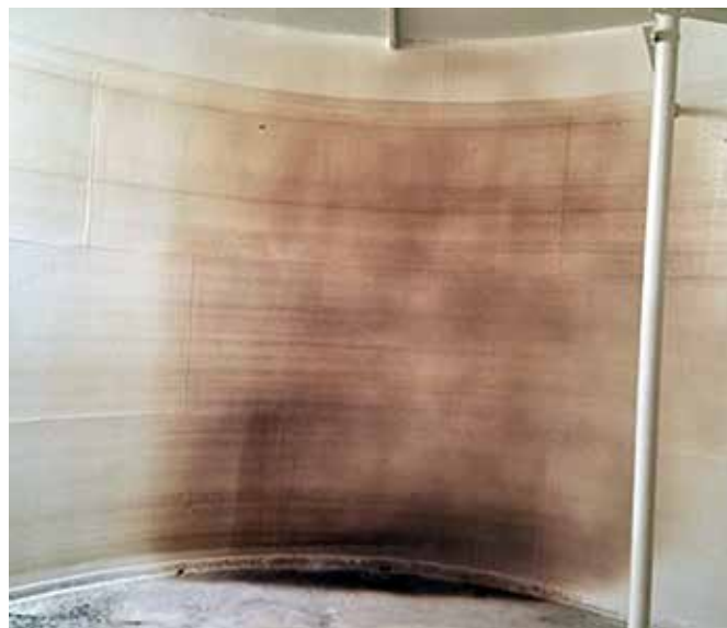
Interior de uno de los estanques sistema Agua Potable Santa Olga luego de incendios. Fuente: Dirección de Obras Hidráulicas MOP Febrero 2017
