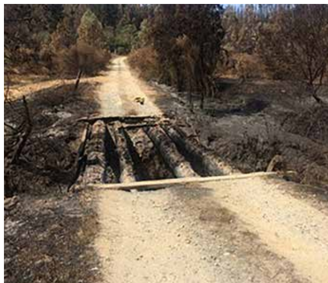
Puente El Rabito. Ruta O-672. Provincia de Concepción, comuna de Florida, con pérdida total del puente por efecto del incendio
