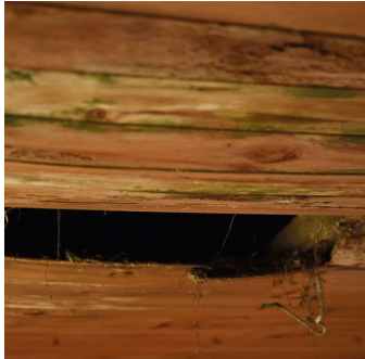
Fotografía 10.2. Huecos en techo y piso.
