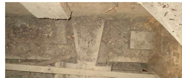
Fotografía 4. Imágenes de algunas de las uniones encontradas en la estructura de la Iglesia de Caulín.
