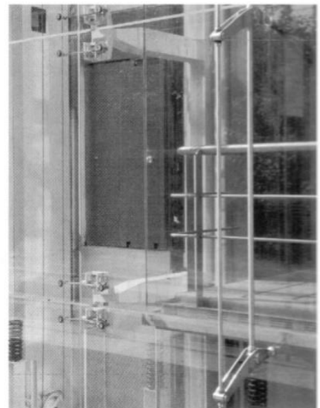
17. La sutil estructura metálica de las cajas de vidrio en las torres de ascensores del Centro de Arte Reina Sofía de Madrid, de I. Ritchie. Las sofisticadas fijaciones y rótulas, con sus brazos de palanca de acero inoxidable, permiten que el vidrio se mueva solidariamente siguiendo toda su caja los movimientos de la torre metálica interior. Uno de los dos redondos de acero cuelga de la parte superior de la estructura; el otro, el exterior, se ancla en el cimiento. Los vidrios colgados del otro extremo de la palanca siguen, reducidos, los movimientos de la estructura. Todo el edificio se mueve gracias a las modernas técnicas de montaje.
