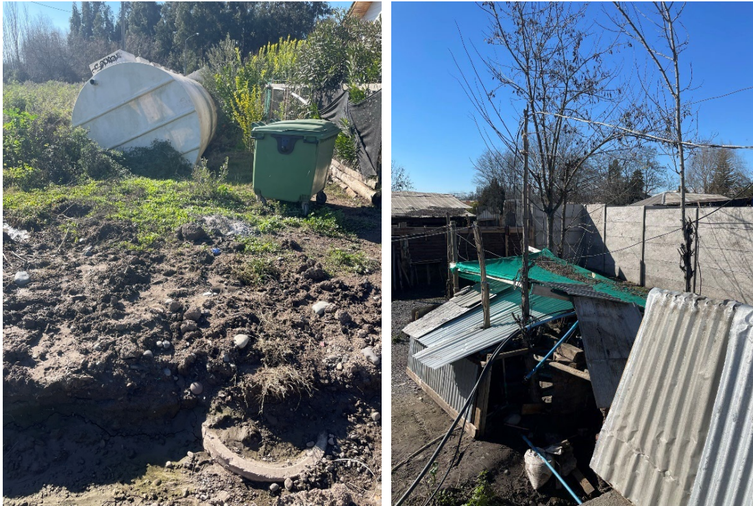
Figura 48 Antiguo sistema unitario de depósito de aguas servidas (izquierda) y actual noria de agua potable de la Villa Esperanza. Fuente: Elaboración propia
