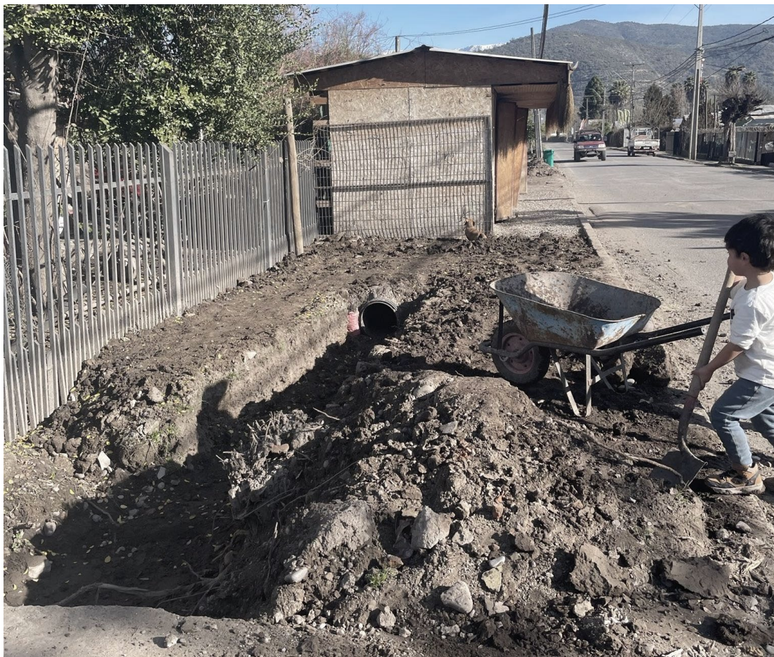
Figura 51 La noche misma de las primeras inundaciones del 2024, los vecinos comenzaron a destapar canales y acequias por su propia cuenta, trabajo que duró más de una semana. Fuente: elaboración propia.
