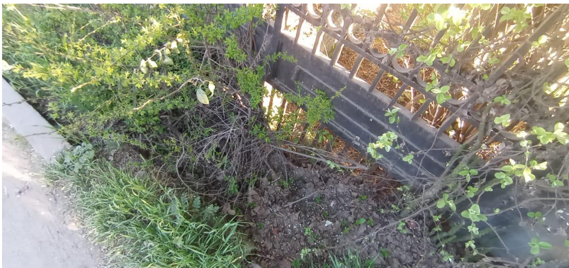
6) Tapadas con rejas (Parcialmente bloqueadas)
