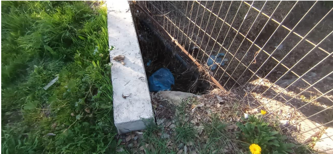
2) Tapadas con rejas (Parcialmente bloqueadas)
