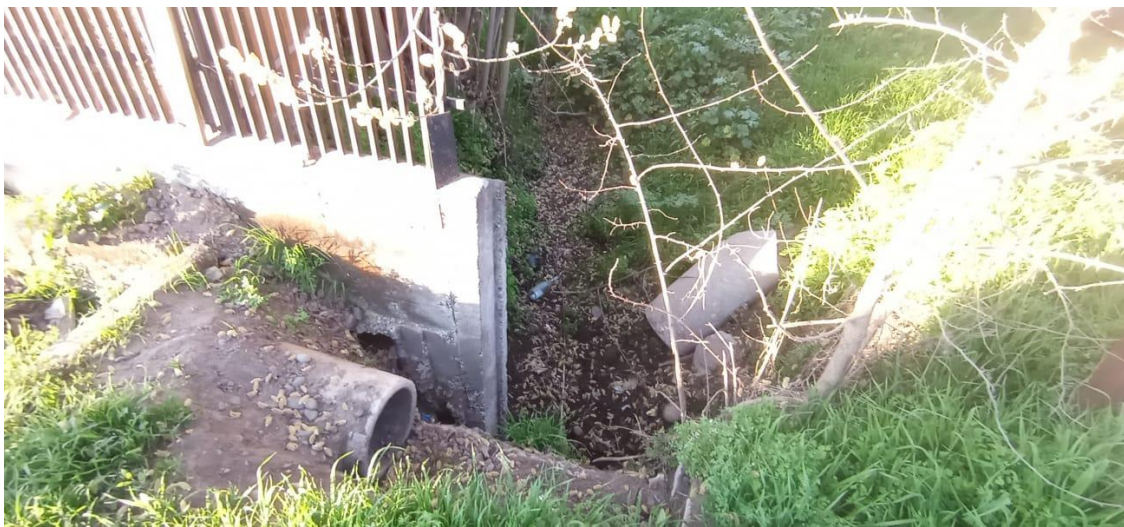
15) Destapadas recientemente producto de lluvias
