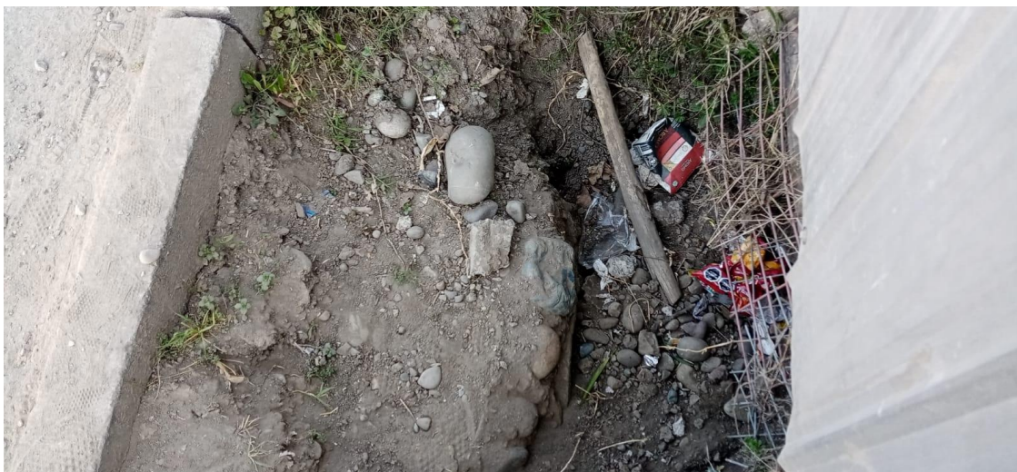
4) Tapadas por falta de mantenimiento (Acción natural)
