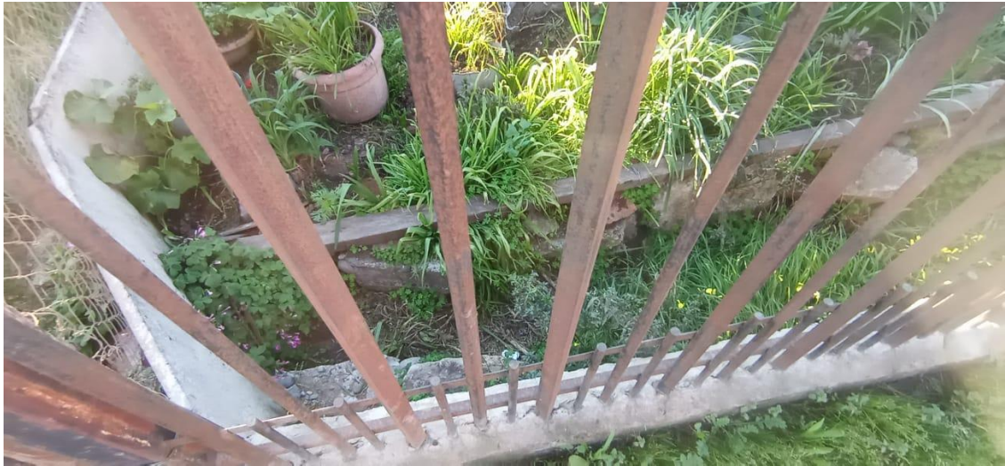
11) Tapadas por falta de mantenimiento (Acción natural)
