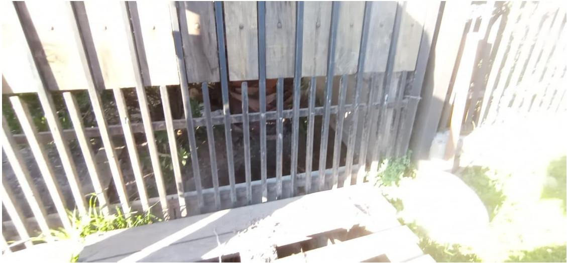
8) Destapadas recientemente producto de lluvias
