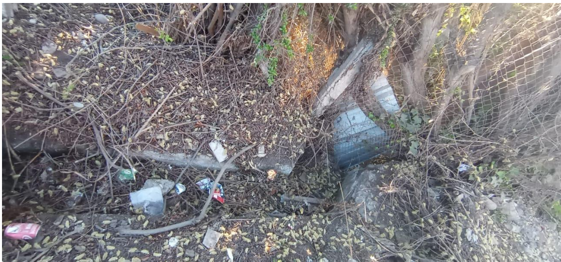
12) Tapadas por falta de mantenimiento (Acción natural)
