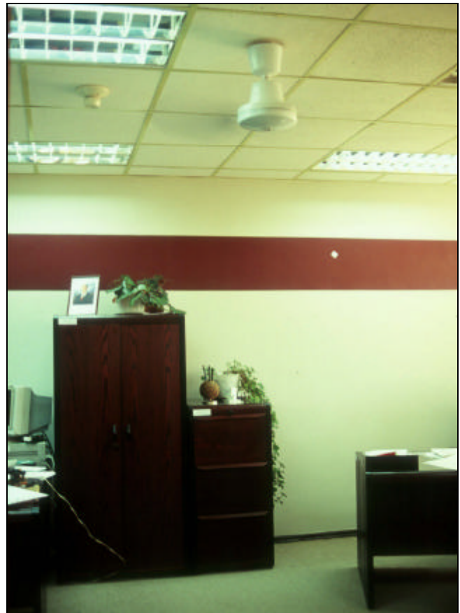
FIGURA 4.5.E. VENTILADOR DE TECHO
