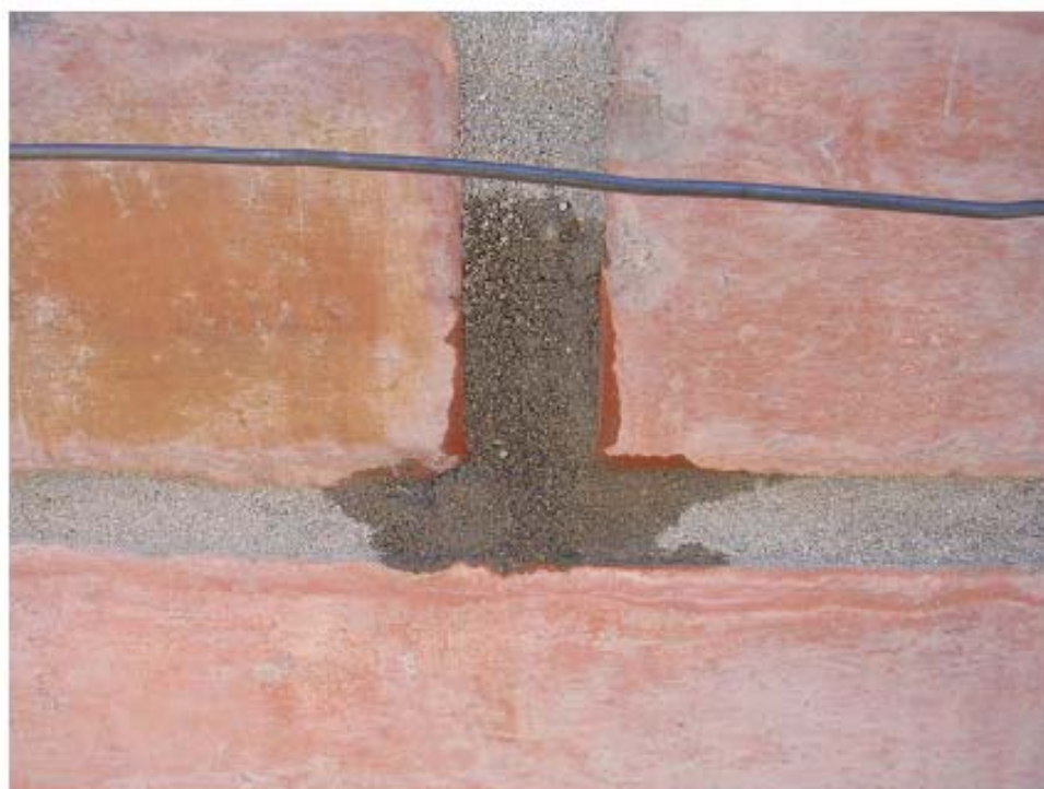
Primer indicio de humedad en Muro 1
