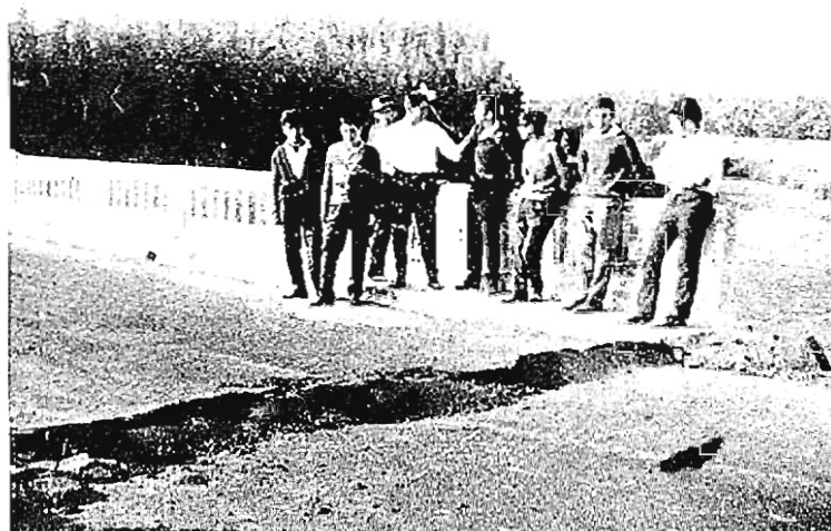
PHOTO 86. — Effet du séisme du 28 mars 1965 sur le pont de la Route panaméricaine au-dessus du Río La Ligua (photographie prise le même jour).
